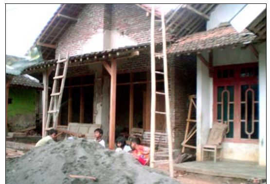
Gambar 1. Saat studi dilakukan, di setiap dusun ditemui masyarakat, terutama keluarga TKI, yang sedang membangun rumah baru mereka.
