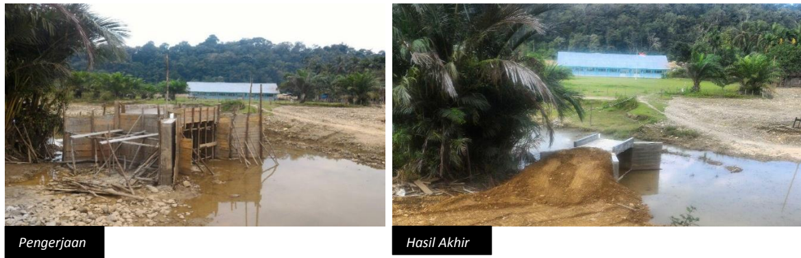
Gambar 15. Pembangunan gorong-gorong persegi di Desa Sungai Seberang, Merangin, yang mendapat nilai kemanfaatan rendah
