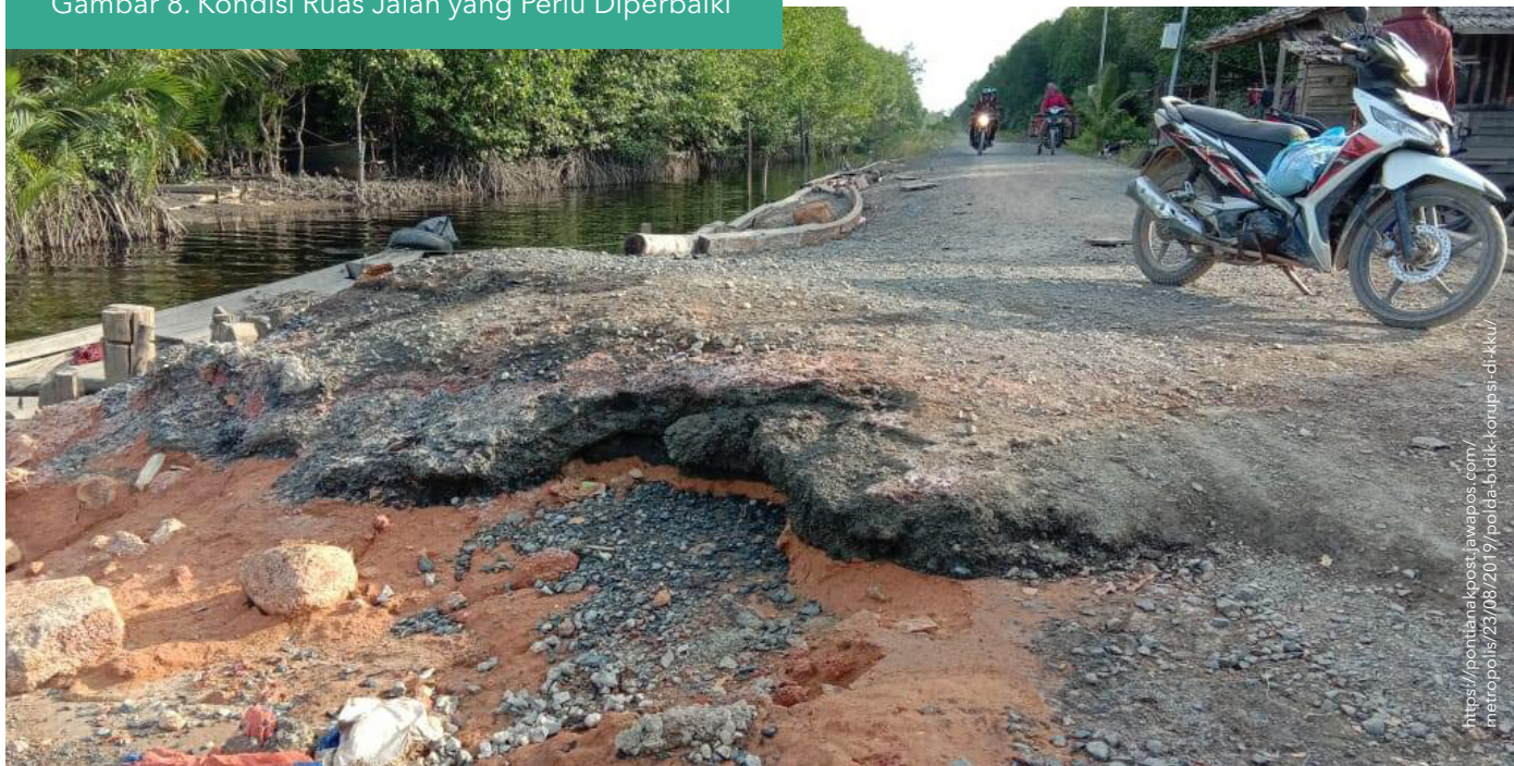
Gambar 8. Kondisi Ruas Jalan yang Perlu Diperbaiki
